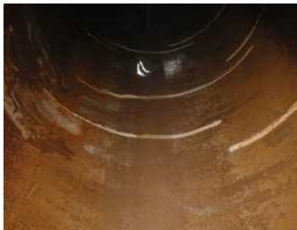
Figura 3.- Fisuras según paralelos del tubo
