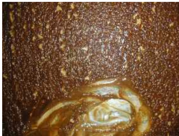
Figura 8.- Incrustación de plástico en cara interior tubería
