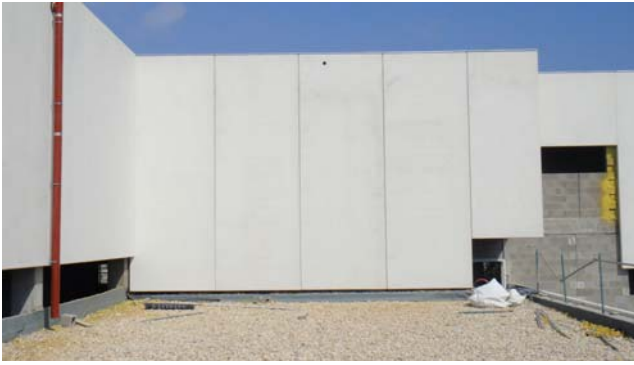
Figura 3. Vista de los paneles con sombras lineales.
